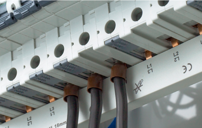
Przejrzyste podłączenie przewodów zasilających przed szyną łączeniową
