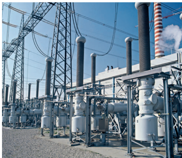
Rys. 1/16 Zastosowanie w sieciach wysokiego napięcia
